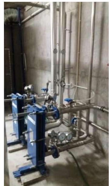
Ilustração 8: Permutadores de placas
